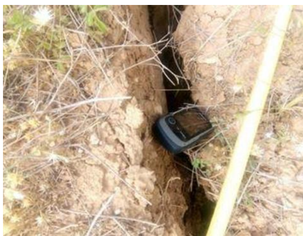
شکل ۱۱. تصاویری از ایجاد شکاف کششی در تاج شیب و آسیب ناشی از آن به سازه‌ها در پروفیل B Fig. 11. Images of tensile crack formation at the slope crest and the resulting damage to structures in Profile B
