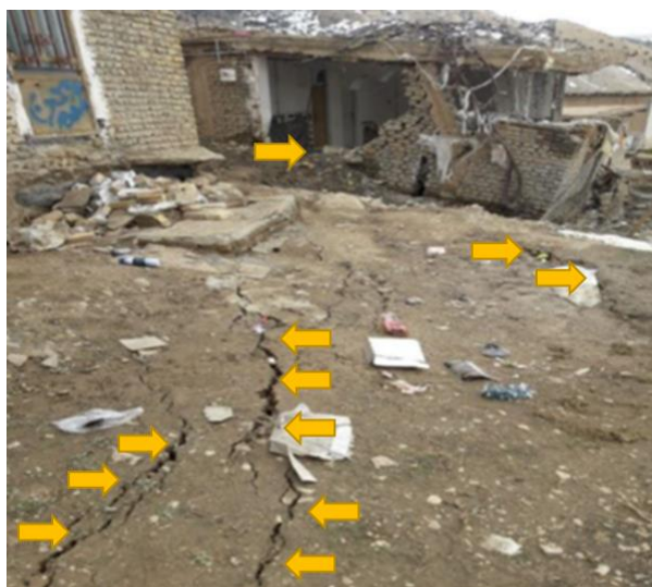
شکل ۹. تصاویری از ایجاد شکاف کششی در تاج شیب و آسیب ناشی از آن به سازه‌ها در پروفیل A Fig. 9. Images of tensile crack formation at the slope crest and the resulting damage to structures in Profile A
