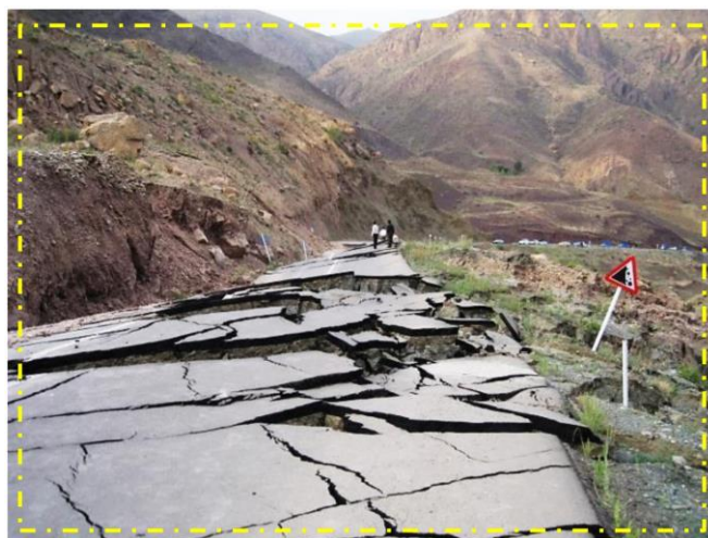
شکل ۱. تخریب جاده اصلی خوی- ترکیه در اثر رخداد زمین لغزشی بزرگ در ۱۲ مرداد ماه سال ۱۳۸۸
