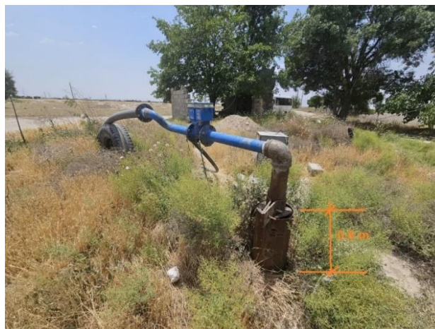
شکل ۲. پدیده لوله‌زایی ناشی از فرونشست یکنواخت در دشت هشتگرد
