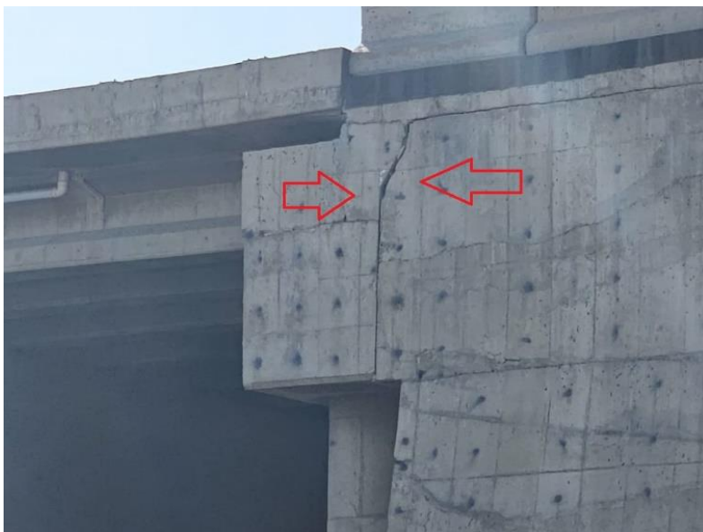
شکل ۹. ترک خوردگی در کوله پل (کرج- جاده قزل حصار)
