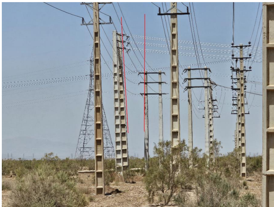
شکل ۷. انحراف در امتداد قائم در تیرهای بتنی خط انتقال برق (حدود ۷ درجه) Fig. 7. Vertical deflection in concrete power transmission line beams (about 7 degrees)
