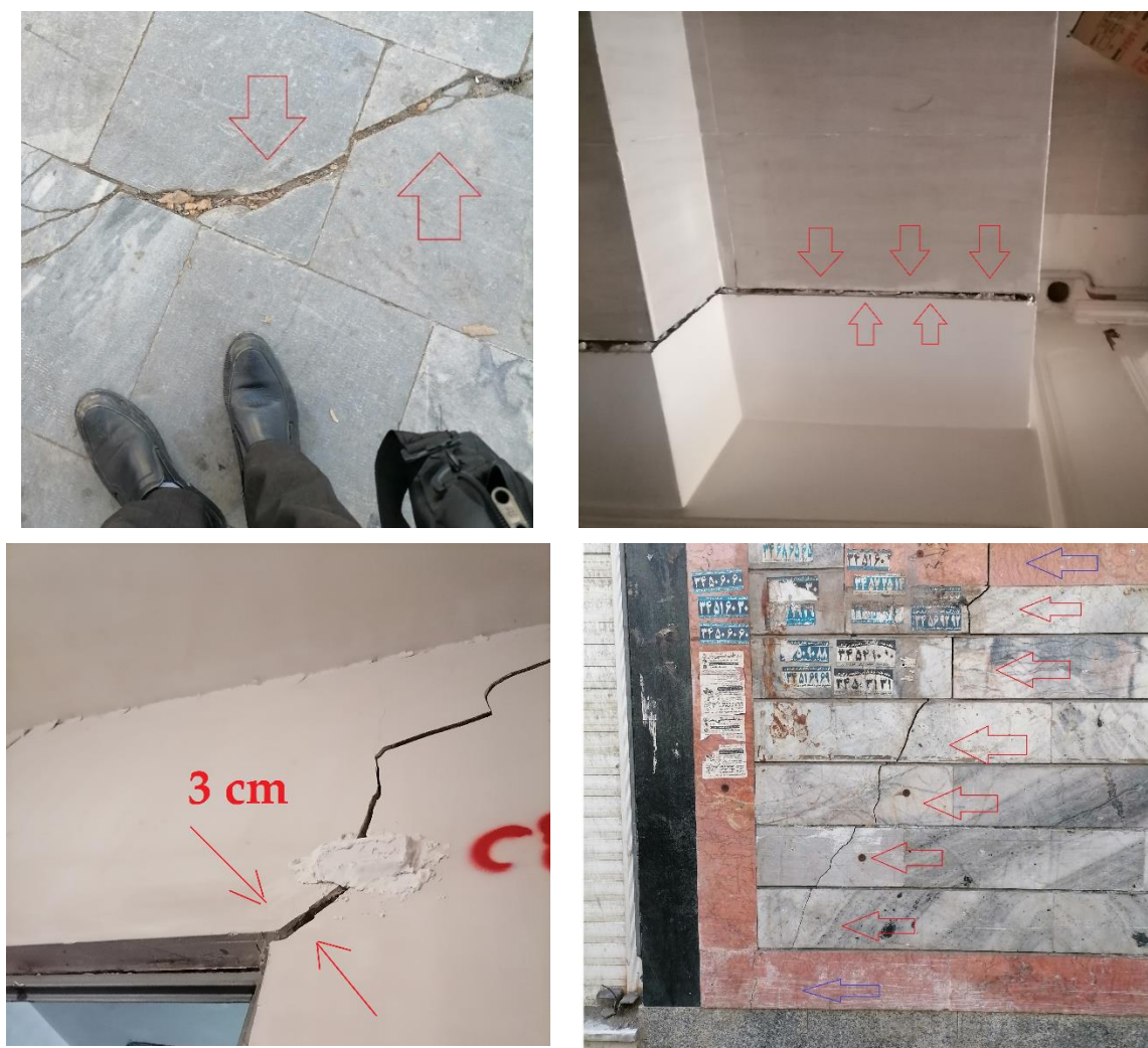
شکل ۸. شواهدی از ترک خوردگی در محله حصارک کرج ناشی از فرونشست موضعی Fig. 8. Evidence of cracking in the Hesarak neighborhood of Karaj caused by local subsidence
