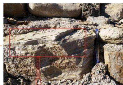
تخریب فیزیکی ناشی از هوازدگی نمک
