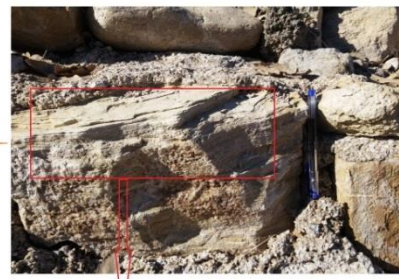
تخریب فیزیکی ناشی از هوازدگی نمک
